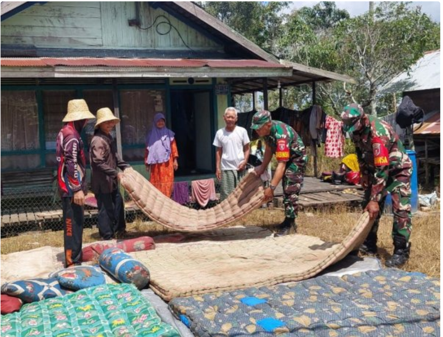
Prajurit Koramil -11/Aluh-aluh Bantu Bersihkan Reruntuhan Rumah Warga Terdampak Musibah Angin Puting Beliung
