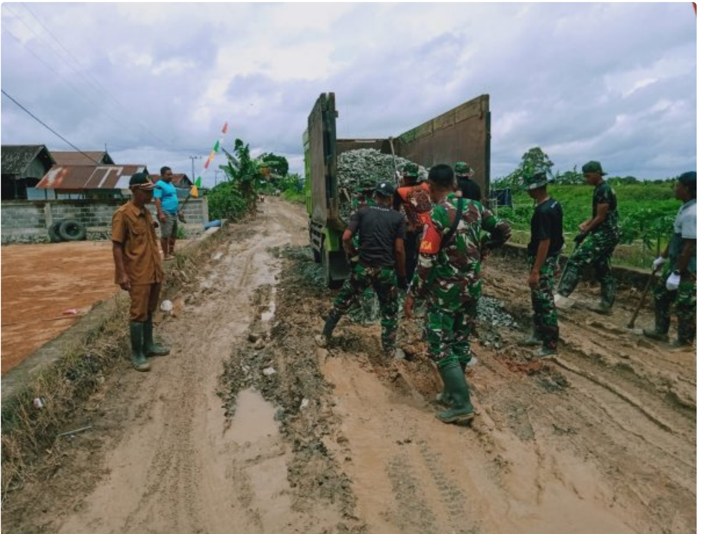
Akses Jalan Rusak Dan Berlubang" Babinsa Bantu Warga Uruk Tanah Dan Batuan
